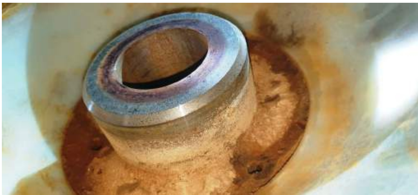
Figura nr.12 - Porțiunea metalică cilindrică aflată la mijlocul crapodinei inferioare a boghiului cu osiile având roțile L3-R3 și L4-R4
