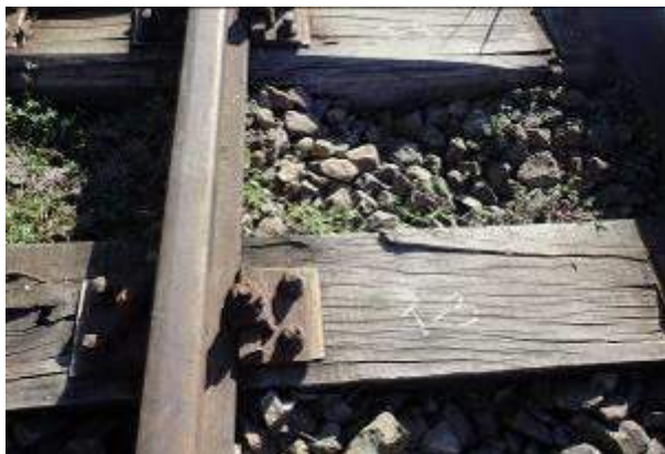
Foto nr.8 - traversele T 3 și T 4
