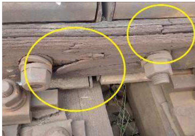
Foto nr.11 – eclisă ruptă în exteriorul căii
