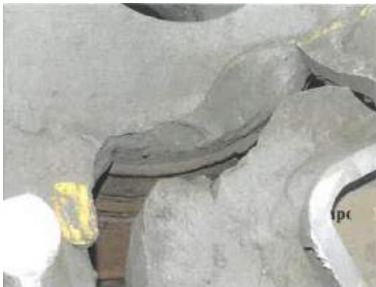
Foto nr. 7. -detaliu crăpătură în jurul suportului
