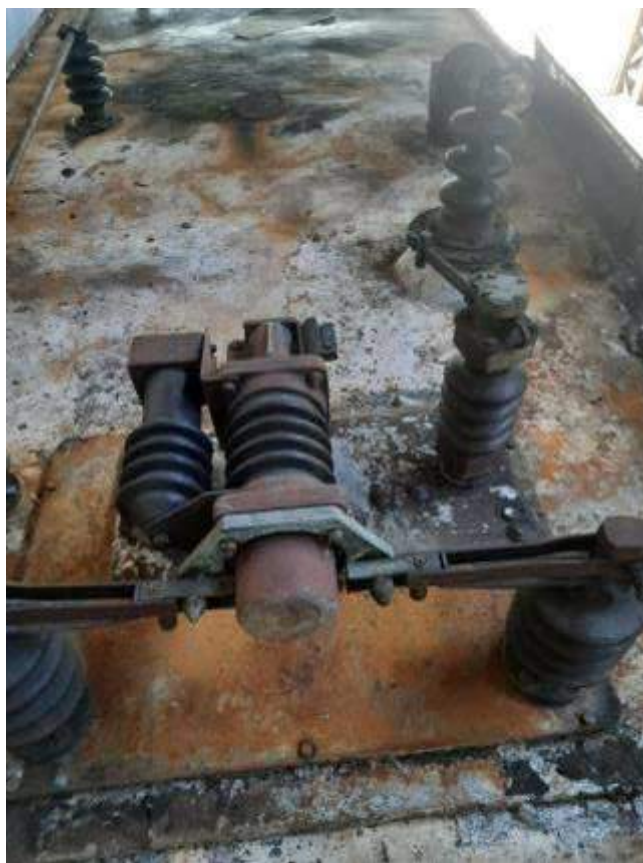
Foto nr.1 – disjunctorul locomotivei tip DBTF
