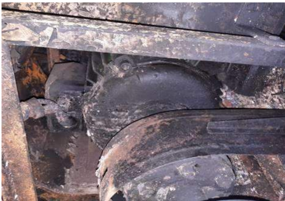
Foto nr.2 - motorul compresorului elicoidal
