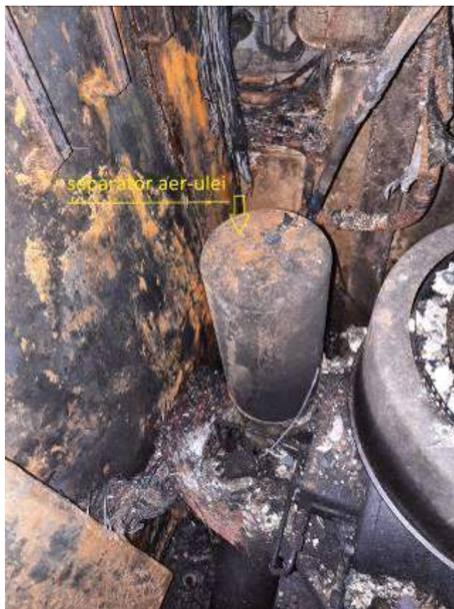
Foto nr.4 - separator aer - ulei
