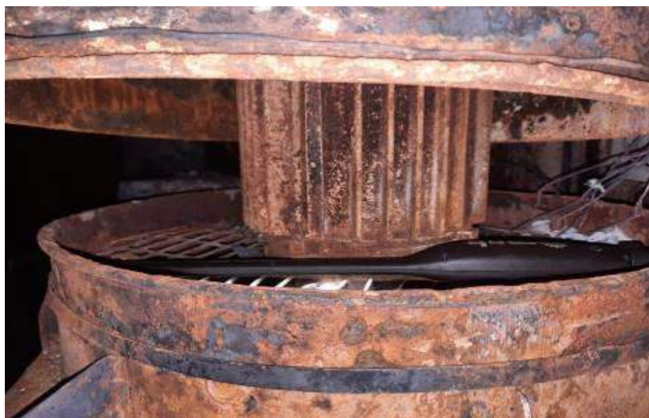
Foto nr.3 – electromotorul răcitorului de ulei
