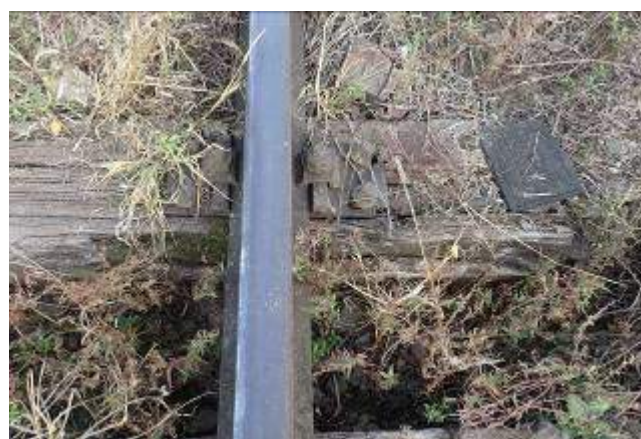
Foto nr.12 - traversa „T1”(șina din dreapta)
