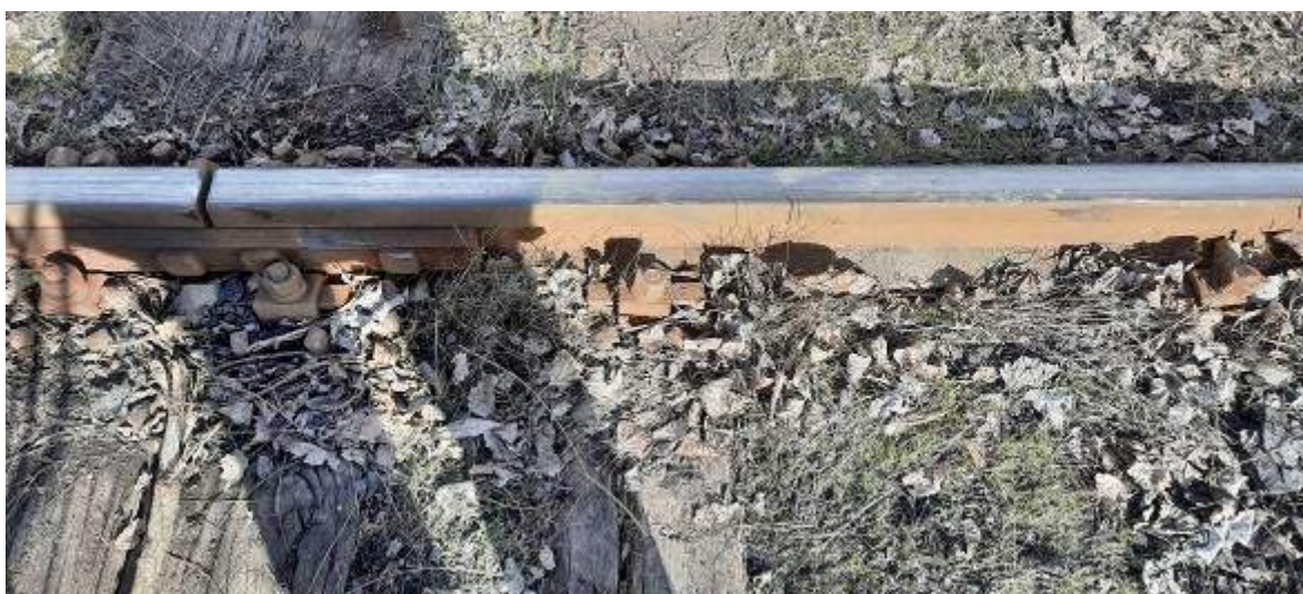
Foto nr.8: starea liniei după deraiere
