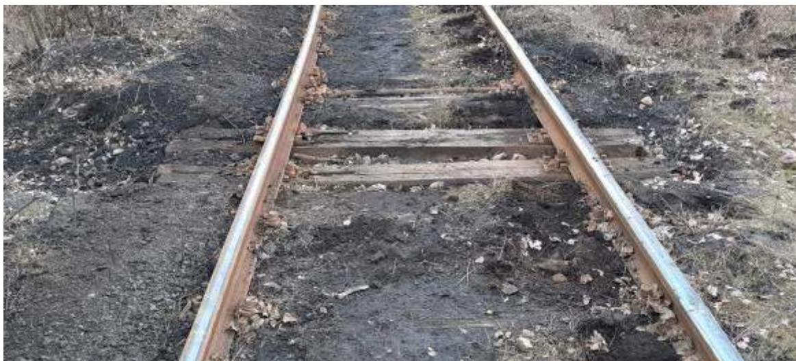
Foto nr.10: starea liniei după deraiere
