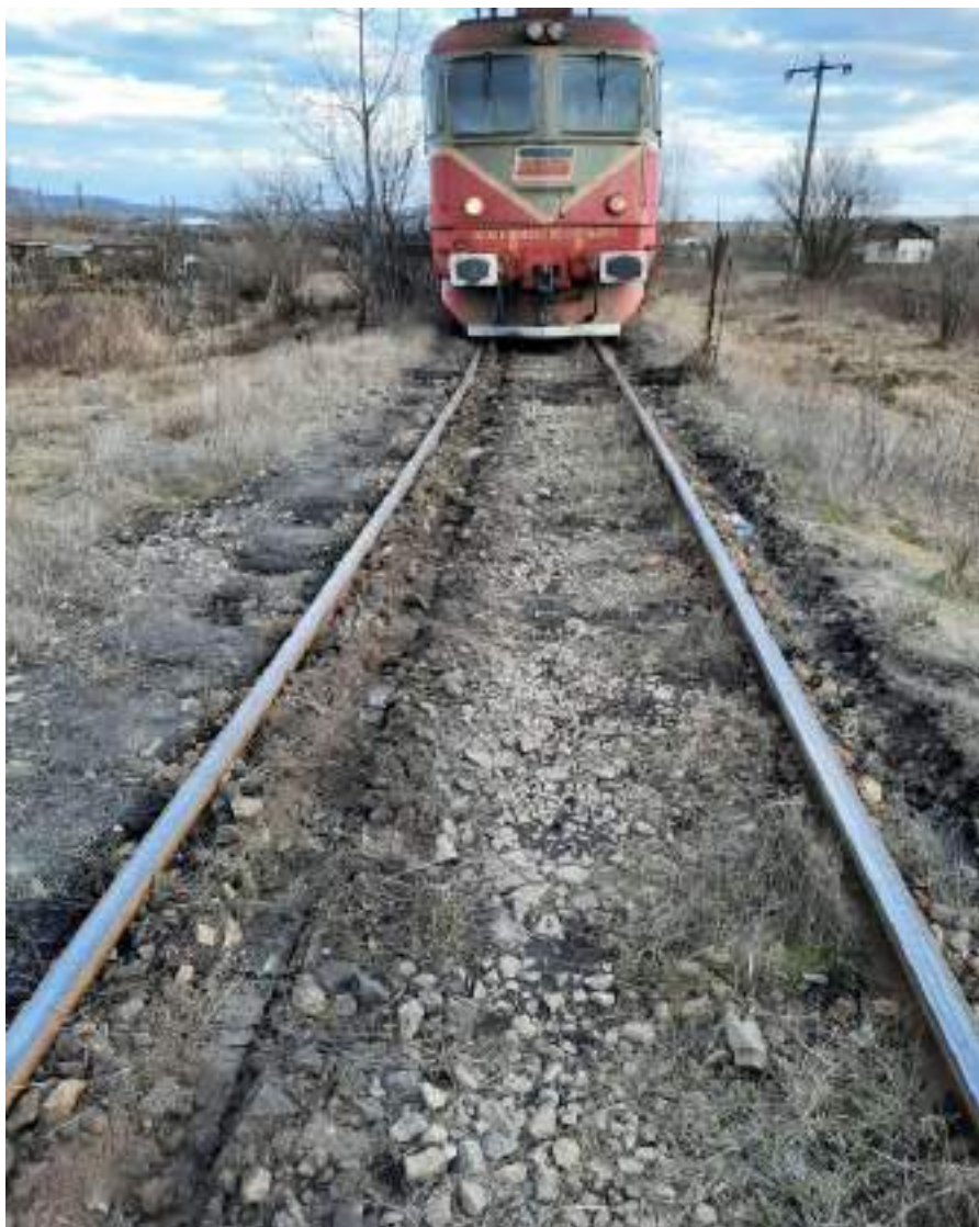
Foto nr.6: starea liniei după deraiere
