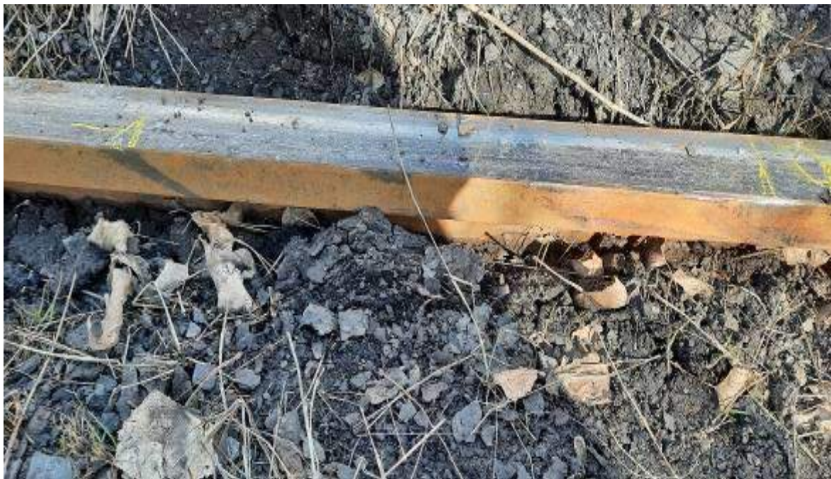
Foto nr.7: starea liniei după deraiere
