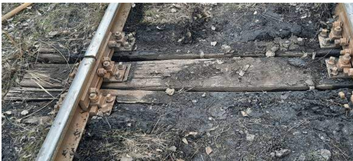
Foto nr.9: starea liniei după deraiere
