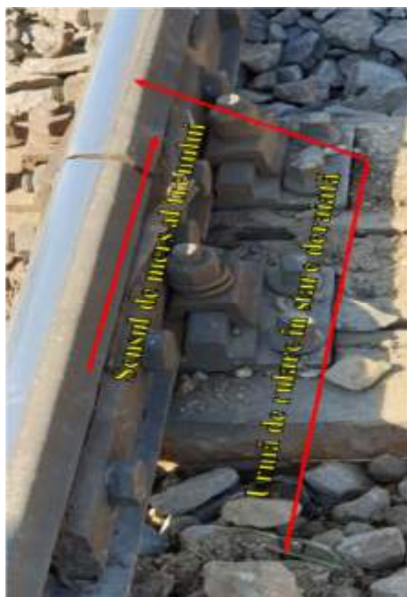
Foto nr.3: Urma de rulare pe ciuperca șinei firului exterior al curbei
