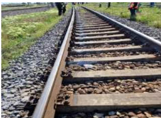
Foto. nr.2 – zona afectată pe linia IV
