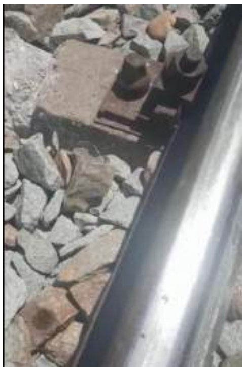
Foto nr.14, capătul traversei din dreptul punctului „0”
