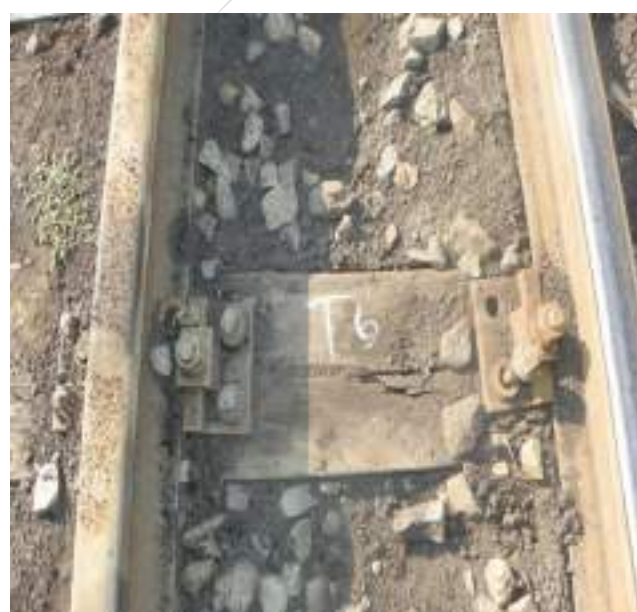
Foto nr.10 Starea tehnică a traversei T6
