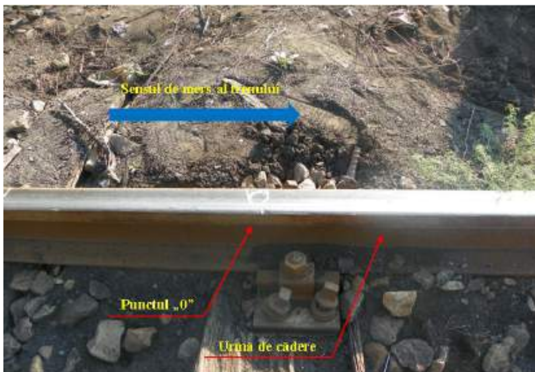
Foto nr.1, punctul „0” – prima urmă de cădere
