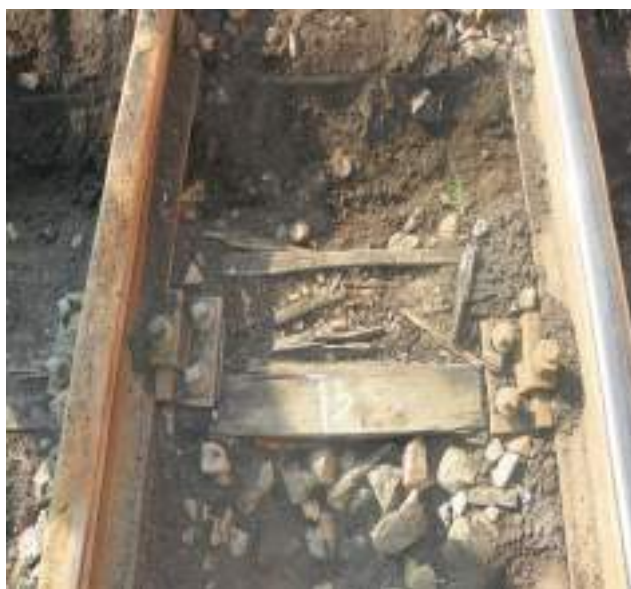
Foto nr. 8 Starea tehnică a traversei T 3
