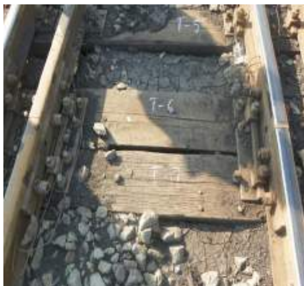
Foto nr.7 Starea tehnică a traversei T-7
