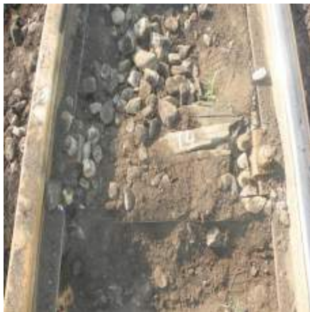
Foto nr. 9 Starea tehnică a traversei T4
