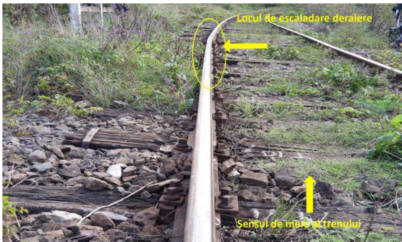
Foto nr.5 – zona unde s-a produs accidentul
