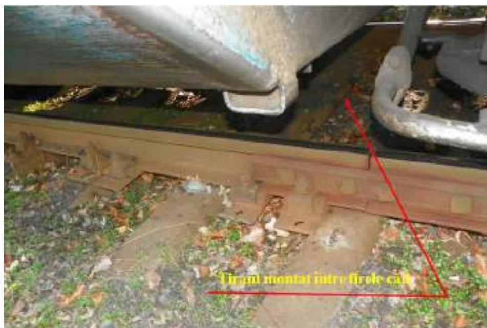
Foto.nr.7 - Tirant montat între firele căii
