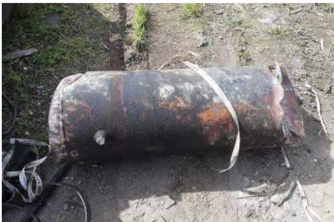
Foto nr.8 – Rezervorul de aer
