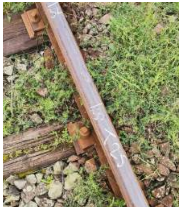
Foto. nr.6 – Starea tehnică a traversei T 25
