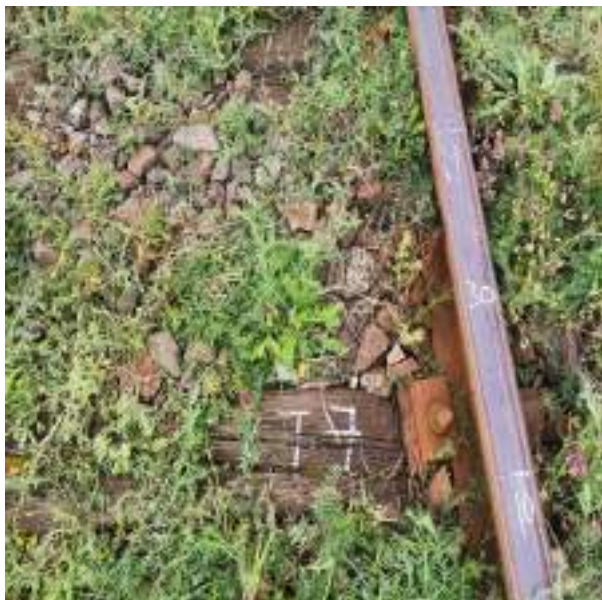
Foto. nr.11 – Starea tehnică a traversei T 7
