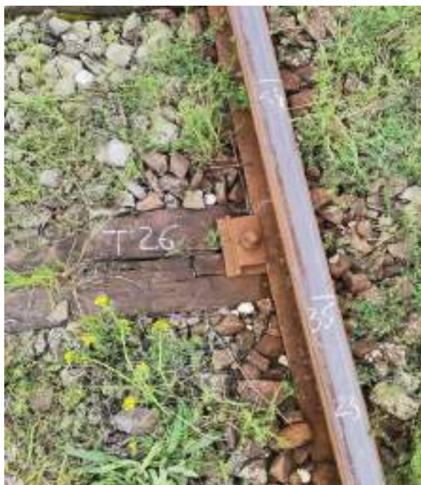
Foto. nr.5 – Starea tehnică a traversei T 26
