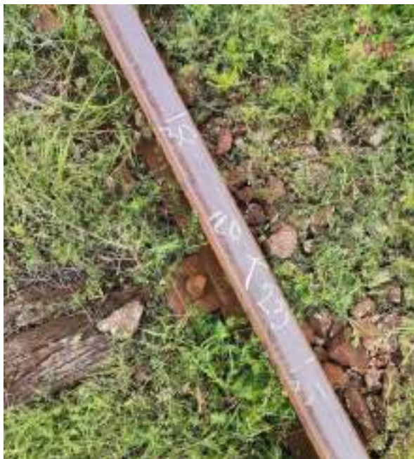
Foto. nr.7 – Starea tehnică a traversei T 23
