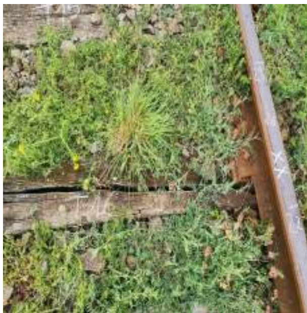
Foto. nr.9 – Starea tehnică a traversei T 16
