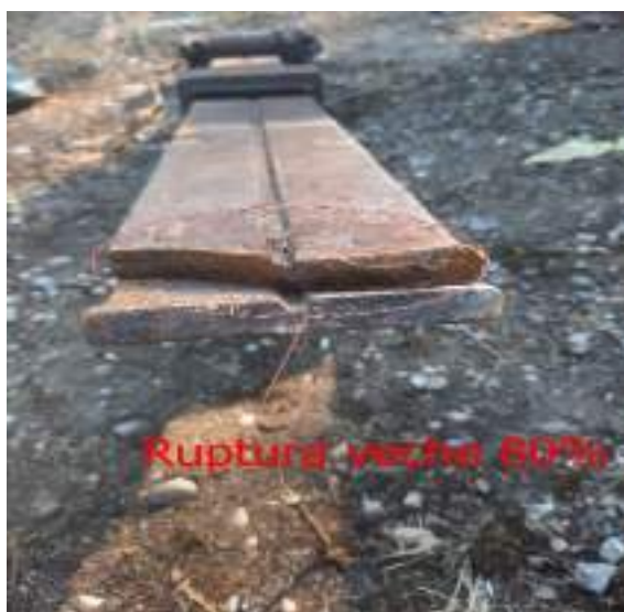
Foto nr.7 Ruptură veche 80%
