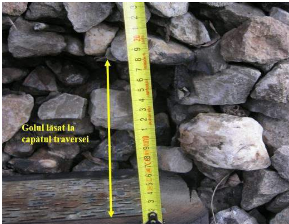
Foto nr.5 – Traversă deplasată
