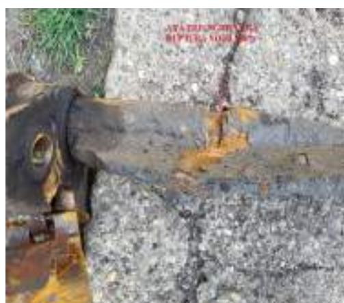
Foto nr.12 axa triunghiulară ruptă nou 100%
