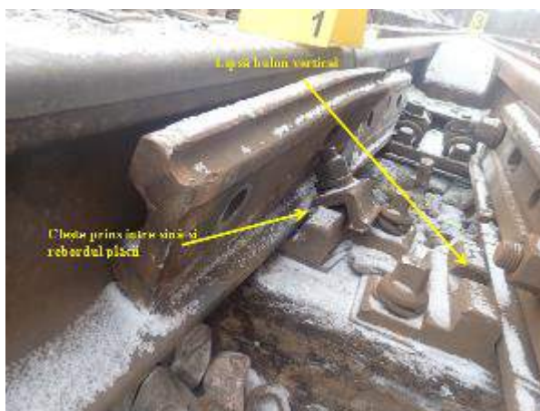
Foto nr.36 – Șurub vertical inactiv și lipsă.
