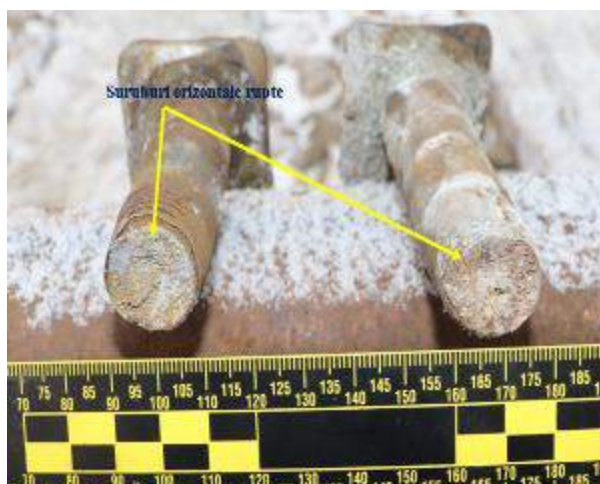
Foto nr.35 – Șuruburi orizontale rupte la punct „0”.
