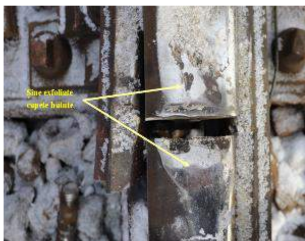
Foto nr.27 – Șine exfoliate, capete bătute
