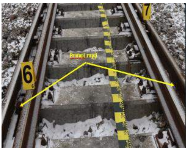
Foto nr. 21 – Proțapi rupți pe ambele fire
