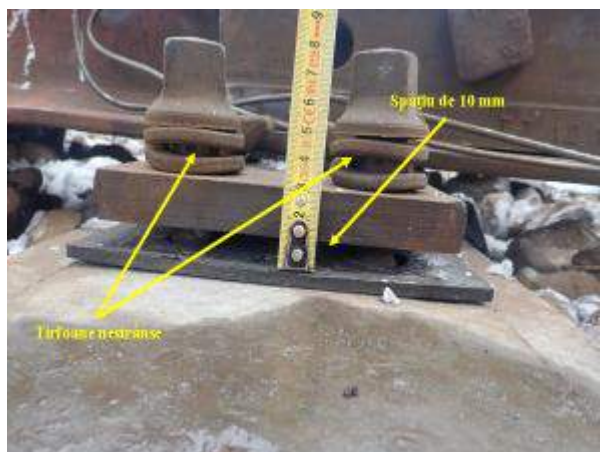
Foto nr.37 – Tirfoane inactive, săltate.
