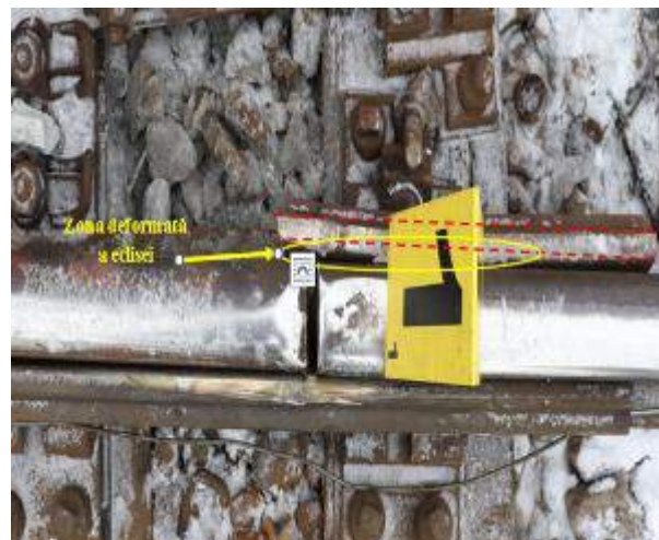
Foto nr.10 – Eclisă ruptă, deformată
