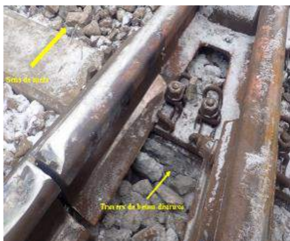
Foto nr.9 – Margine traversă de beton distrusă
