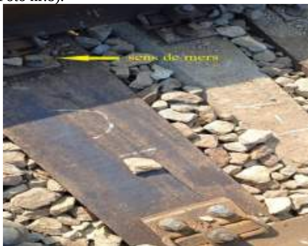
Foto nr.8 starea traverselor în punctul „0”
