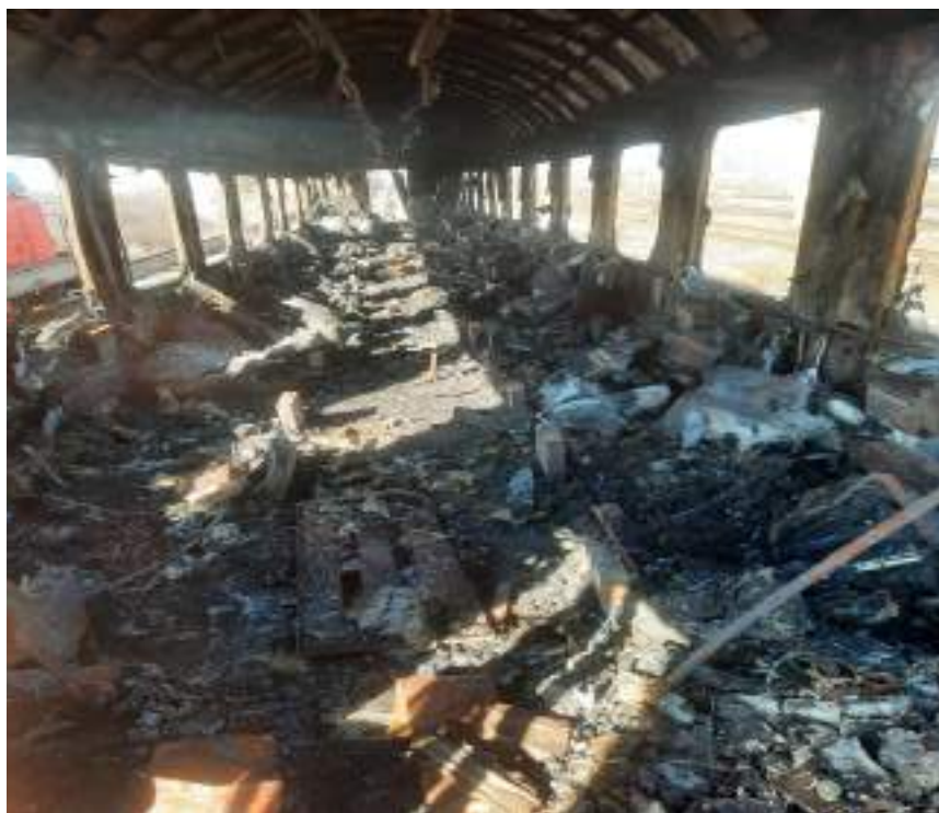
Imaginea nr.5 – interiorul vagonului afectat de incendiu
