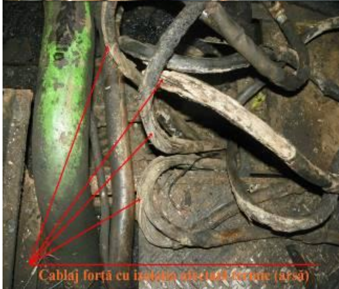
Fig.4 Cablajul de forță al MET nr.4 înainte de jugul de fixare în canalul de cabluri
