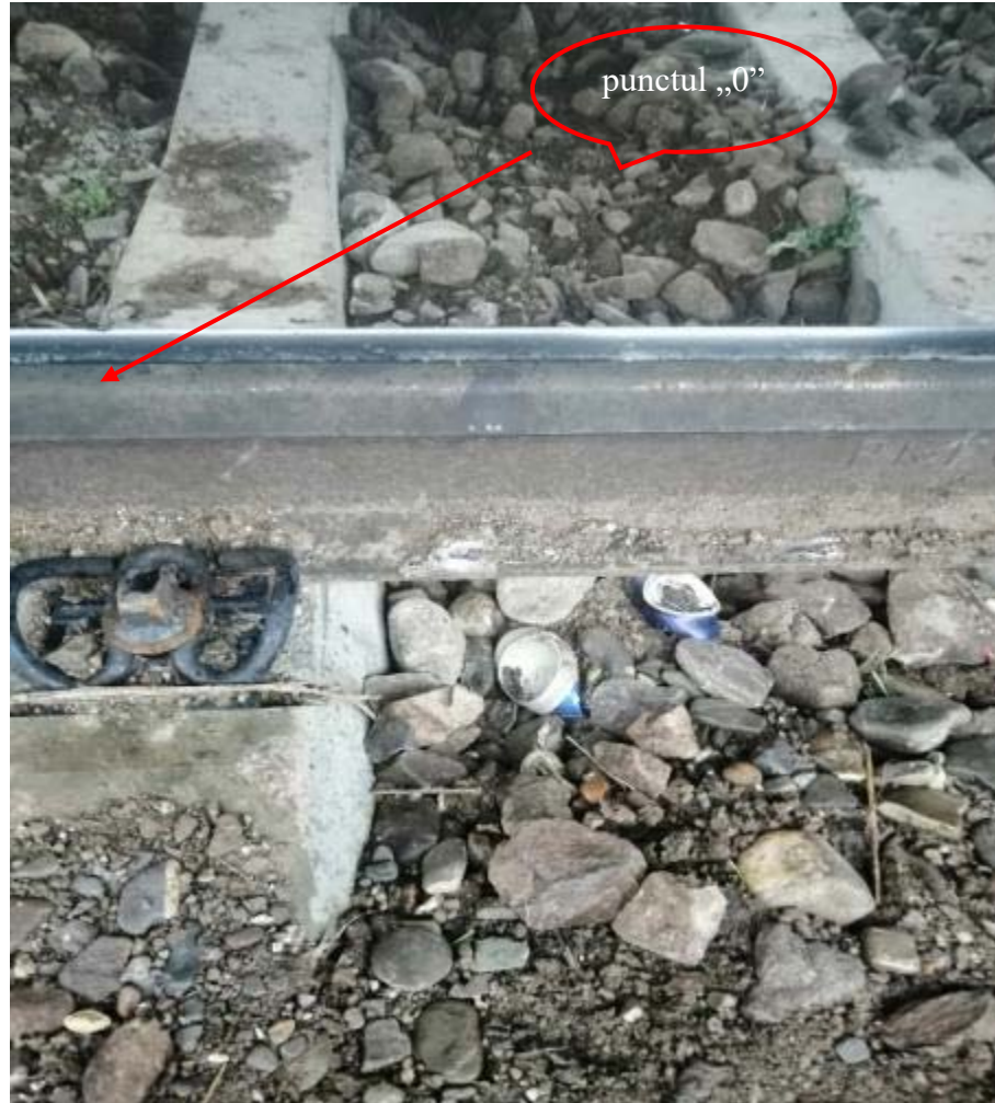
Foto nr. 1 - Prima urmă de escaladare a roții atacante a primei osii a locomotivei EA 038 a fost identificată pe șina din dreapta, sens de mers, la km. 0+843, denumit punctul „0”.
