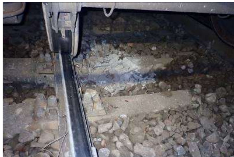
Foto nr.11 – traversa de beton spartă
