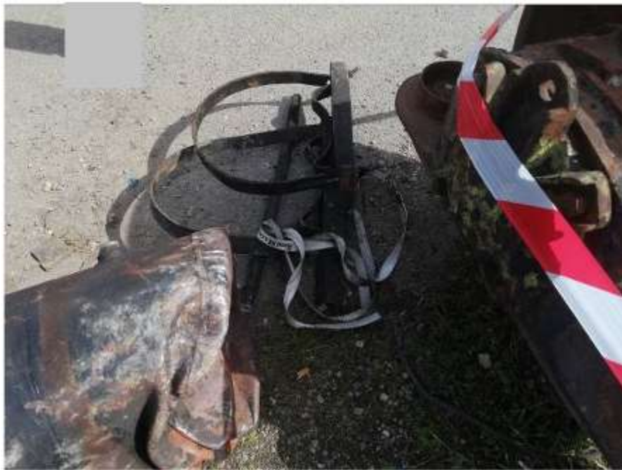
Foto nr.9 - Bara de comutare G-Î ruptă și suportii de susținere a rezervorului de aer
