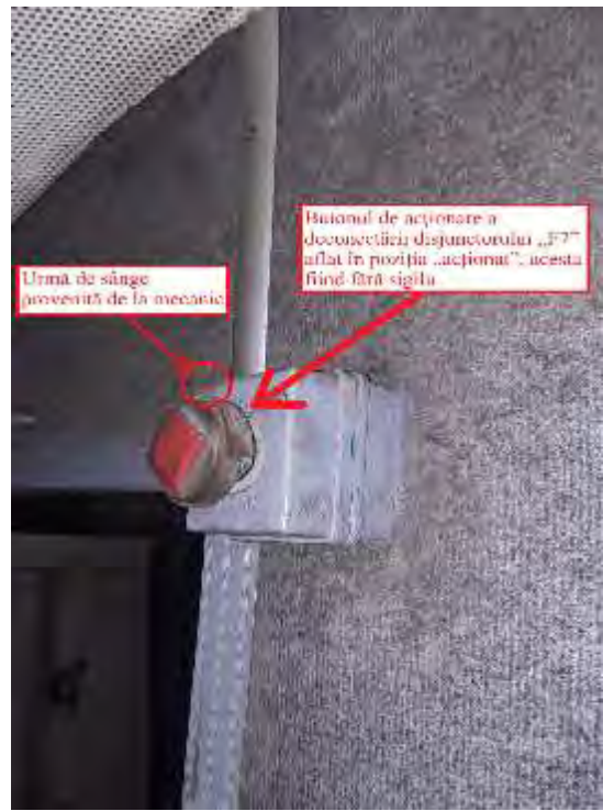
Foto nr.2 - butonul de acționare a deconectării disjuncteurului „F7”
