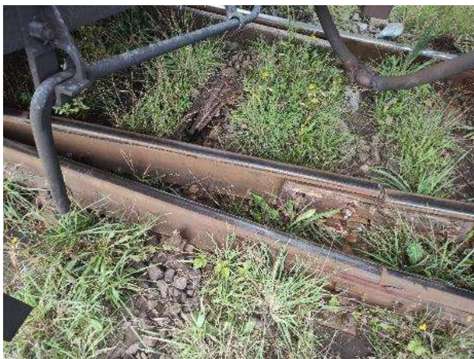
Figura nr.7 – starea traverselor aflate în compunerea schimbătorului de cale R8.
