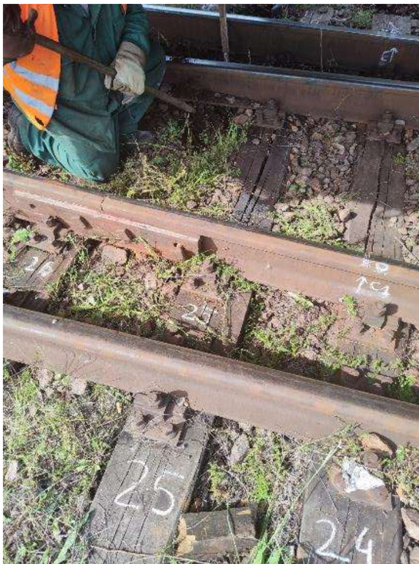
Figura nr.6 – starea traverselor aflate în compunerea schimbătorului de cale R8.
