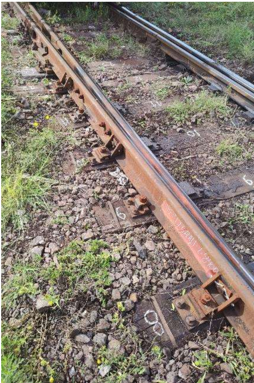
Figura nr.4 – starea traverselor aflate în compunerea schimbătorului de cale R8.
