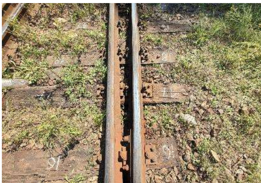
Figura nr.5 – starea traverselor aflate în compunerea schimbătorului de cale R8.
