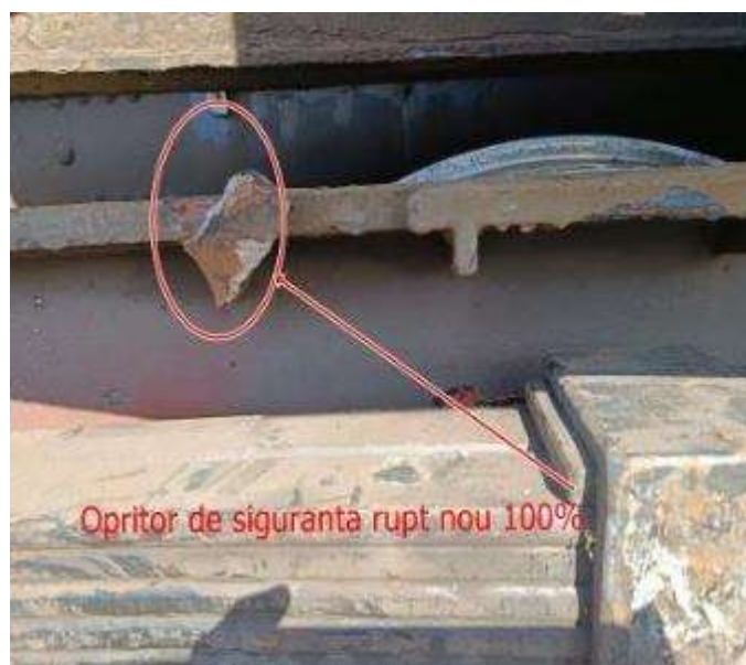
Foto nr.3 – opritor de siguranță ruptură 100% nou
