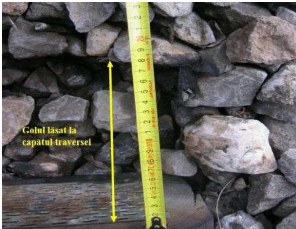
Foto nr.5 – Traversă deplasată
