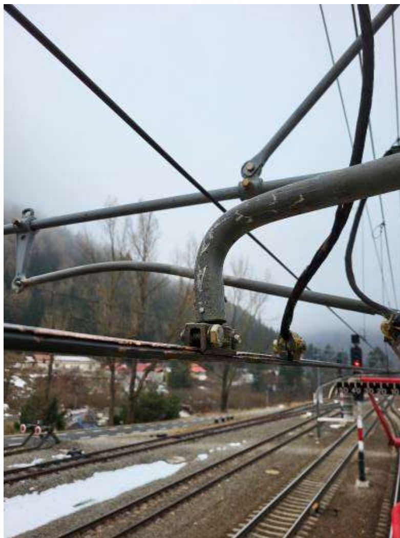
Foto nr.12 – zona ultimei pendule și a fixătorului stâlpului de la acul aerian pe linia directă nr.II la stâlpul SH 31
