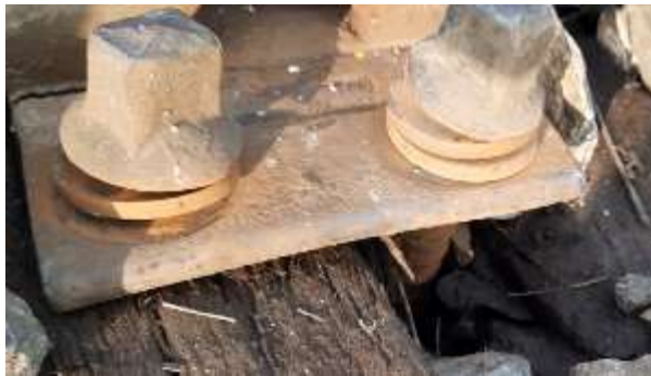
Imaginea nr.18 - detaliu traversa T-1, prinderea plăcii metalice care susține șina firului interior a curbei
