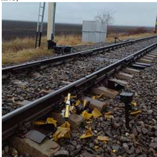
Foto nr. 6- inductor de 2000 Hz avariat
