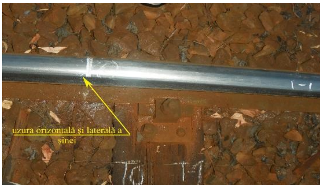
Foto nr.4: Uzura orizontală și laterală a șinei
