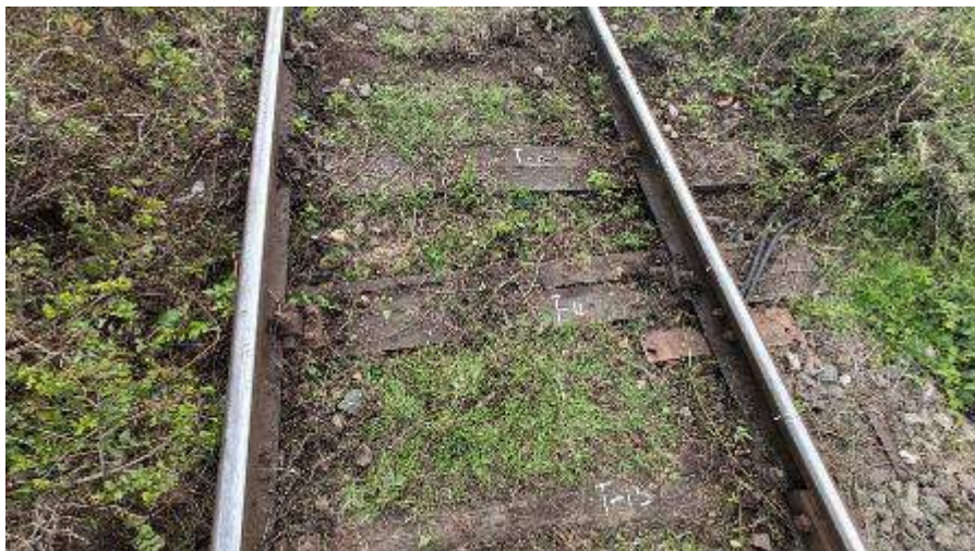
Foto. nr.12,13,14 – Starea traverselor aflate în cale și gradul de colmatare a prisme de piatră spartă
