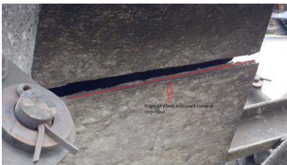
Foto nr.7 – Placă inferioară traversă crapodină ruptă pe toată lățimea
