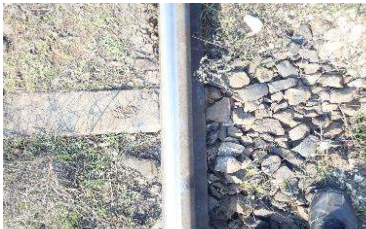
Foto. nr.5,6,7 – Starea traverselor aflate în cale și gradul de colmatare a prisme de piatra spartă
