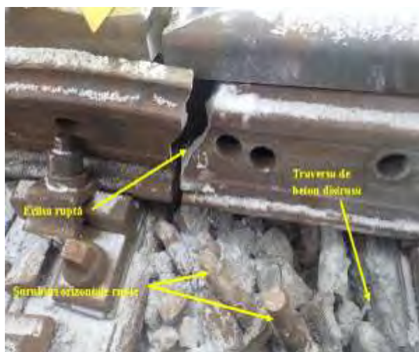
Foto nr. 11 – Eclisa ruptă, deformată
