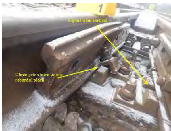
Foto nr.36 – Șurub vertical inactiv și lipsă.
