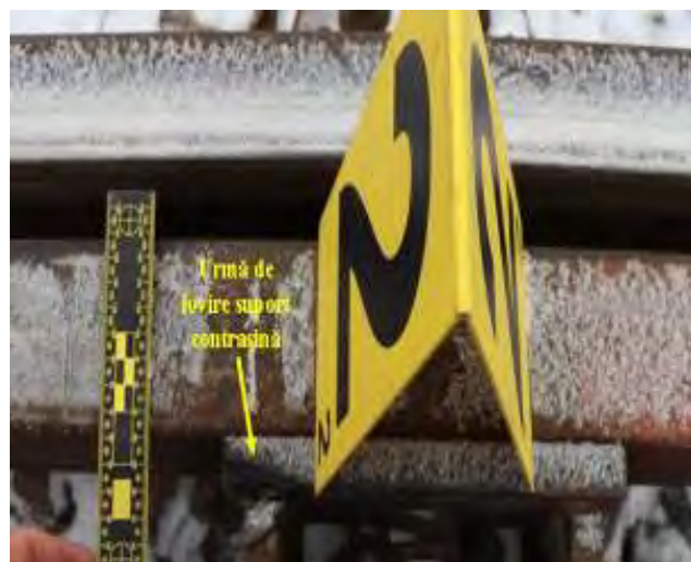
Foto nr.20 – Urmă lovire suport contrașină
