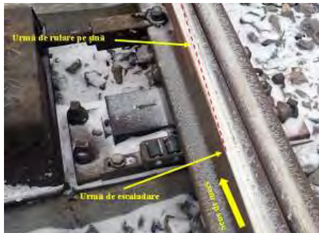
Foto nr.24 – Urmă de escaladare ac de către roata nr.5
