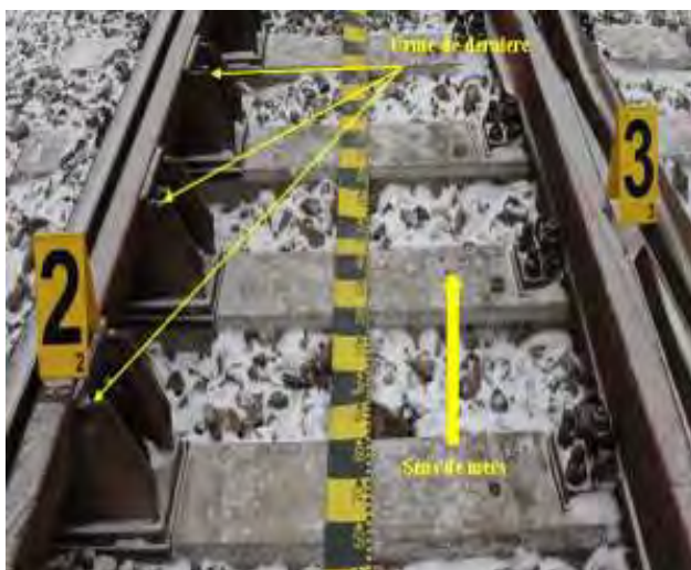
Foto nr.19 – Urmă lovire suport contrașină
