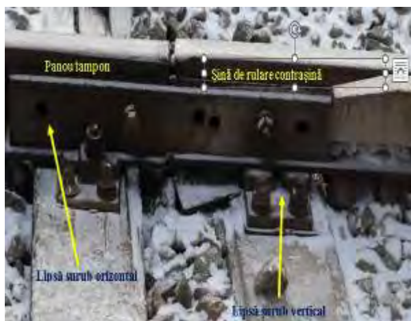
Foto nr.33 – Joanta după contrașină fir stâng int.
