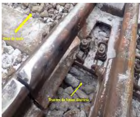
Foto nr.9 – Margine traversă de beton distrusă
