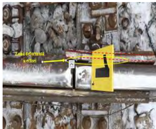
Foto nr.10 – Eclisă ruptă, deformată
