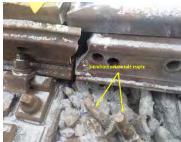
Foto nr.8 – Șuruburi orizontale rupte
