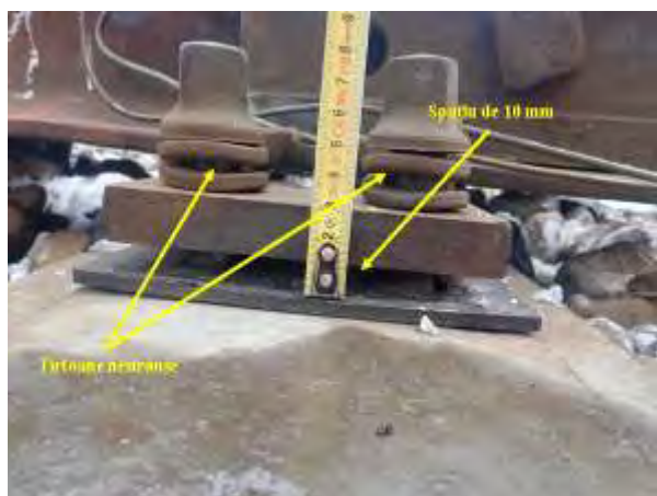
Foto nr.37 – Tirfoane inactive, săltate.
