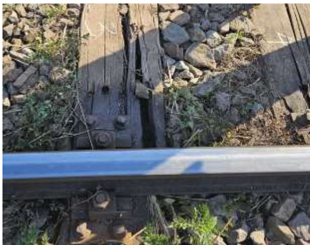
Foto.nr.11 – Traversele T 3 , T 4
