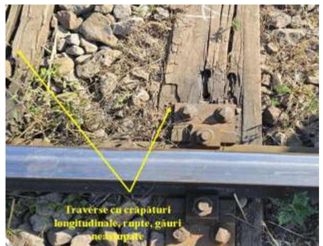
Foto.nr.12 – Traversele T 3 , T 4
