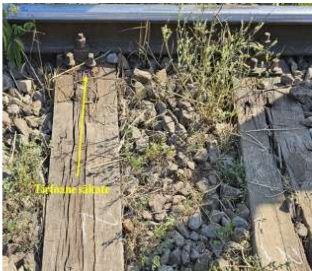
Foto.nr.9 – Traversele T 2 , T 3
