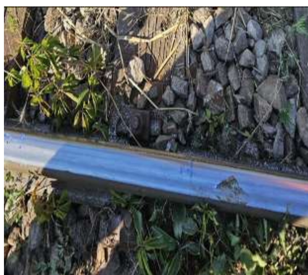
Foto.nr.18 – Pilitură pe talpa șinei și traversă
