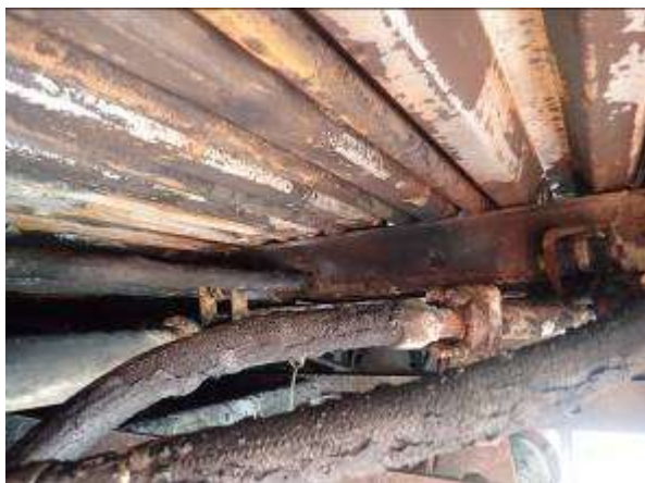
Foto nr.7- zonă afectată de incendiu
