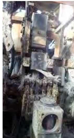
Foto nr.6 Contactorul S3.3
