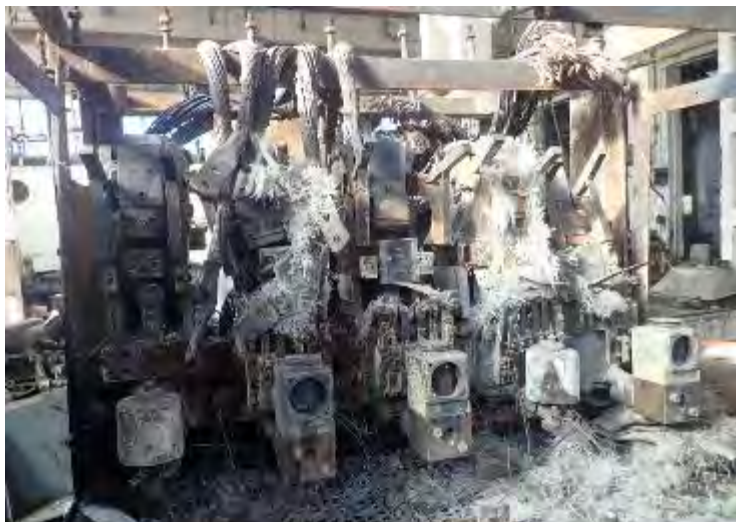
Foto nr.3 Bloc aparate S3
