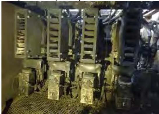
Foto nr.1 Blocul de aparate S1
