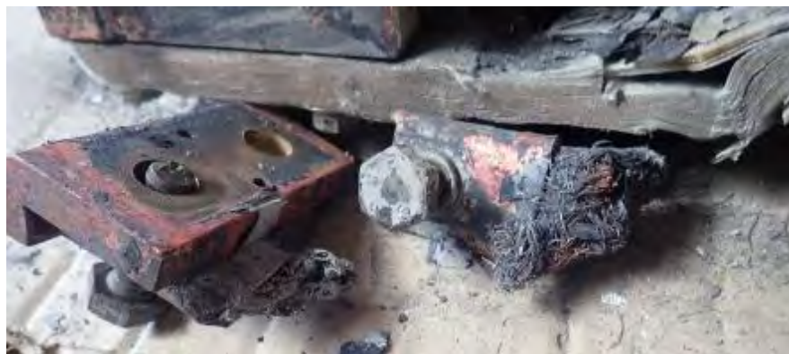
Foto nr.10 Conexi flexibile multifilare aferente contactului mobil prezintă un mănunchi de fire rupte
