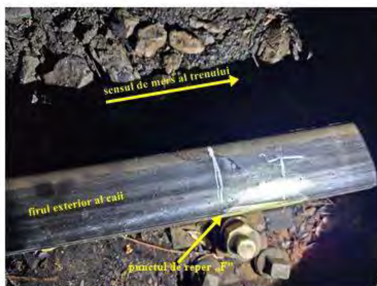
Foto nr.7: Punctul „F” – urma de escaladare pe firul exterior al căii de către roata din partea dreaptă a osiei nr.3, în sensul de mers
