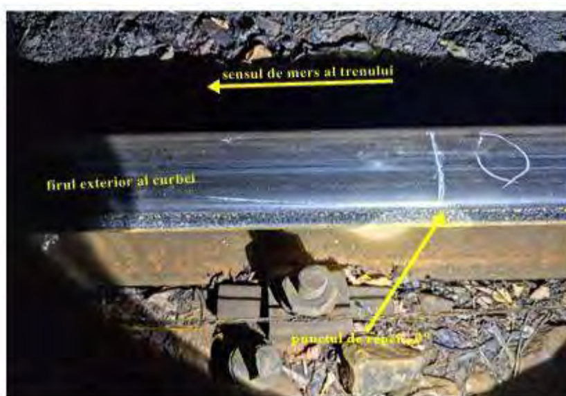
Foto nr.1: Punctul „0” al accidentului feroviar (prima urmă de escaladare a feței active a firului exterior al căii, la km 24+833)
