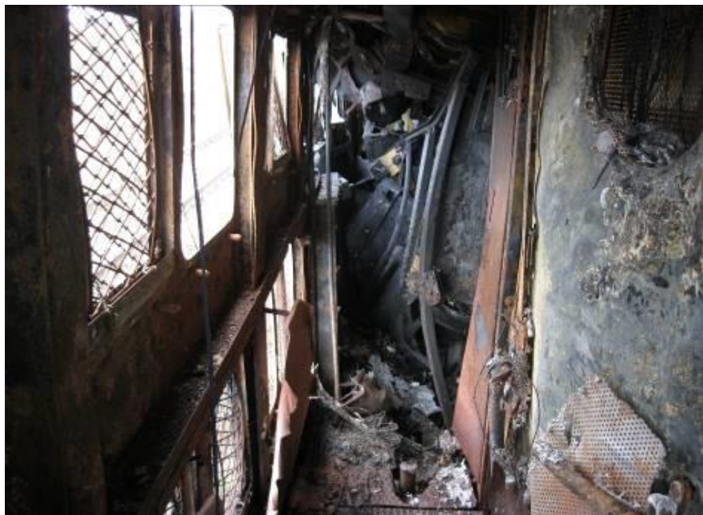
Foto nr.1 – culoar sala mașinilor
