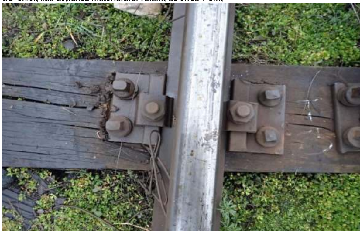
foto nr.8: traversa T-3 (partea stângă în sensul de mers al trenului)
