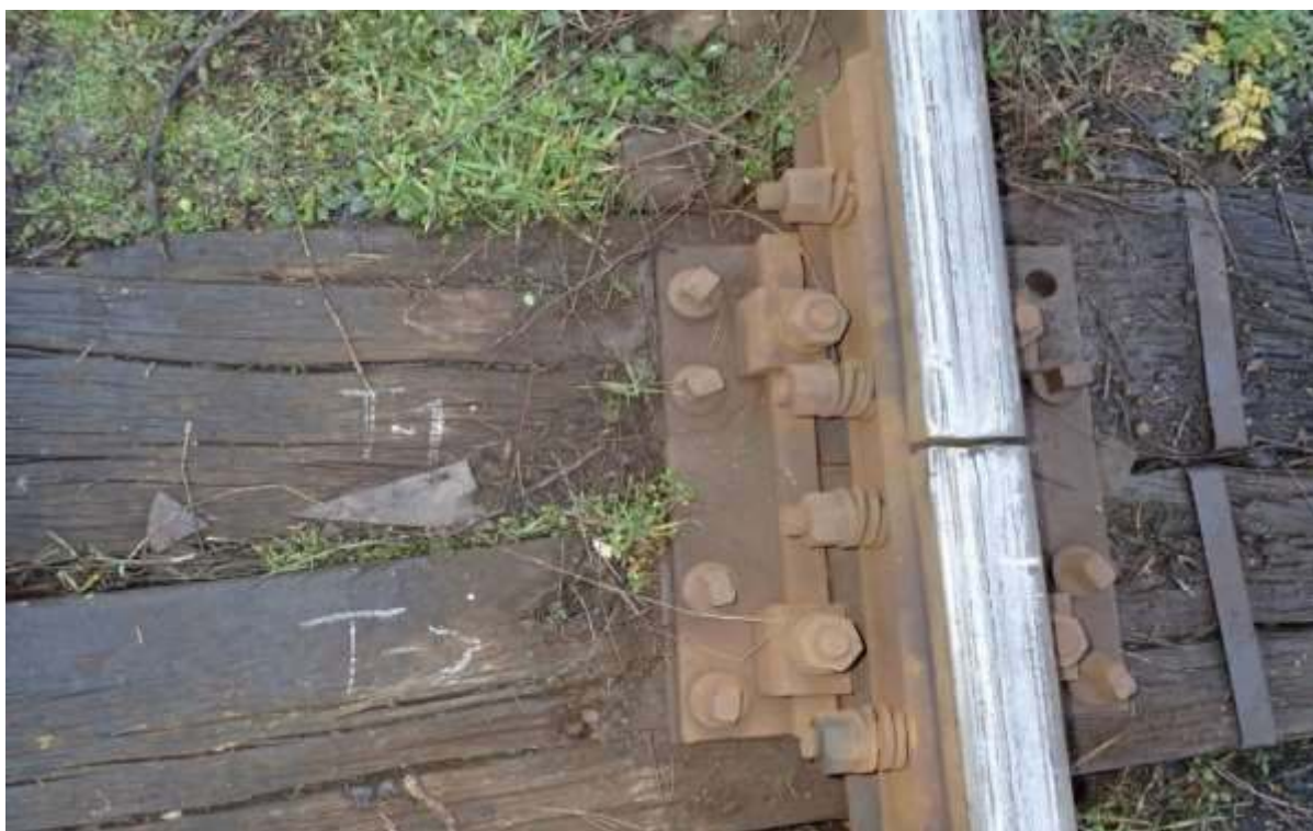
foto nr.7: starea traverselor T-1, T-2 (partea dreaptă în sensul de mers al trenului)
