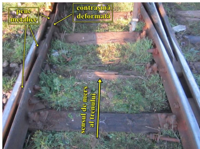
foto nr.7 – contrașina deformată
