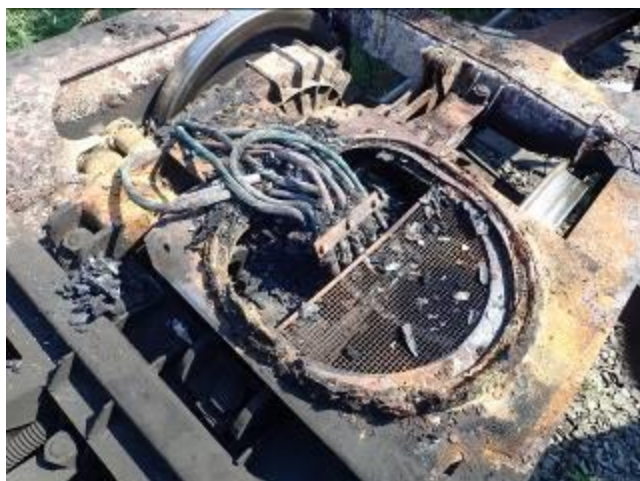
Foto nr.7 cablurile de alimentare cu izolația arsă
