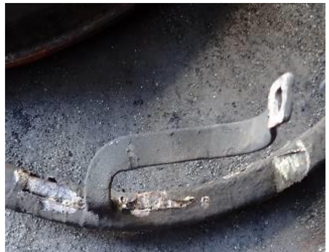
Foto nr.4 izolația carbonizată pe bara de înseriere
