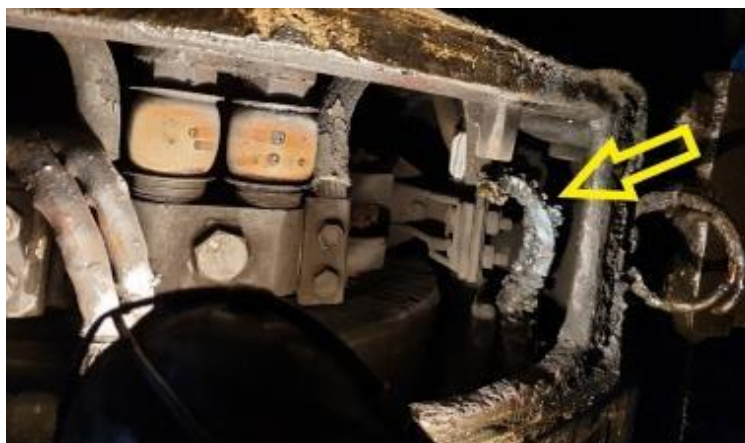
Imaginea 6 – conexă supraîncălzită și cu izolația arsă – în interiorul MET4
