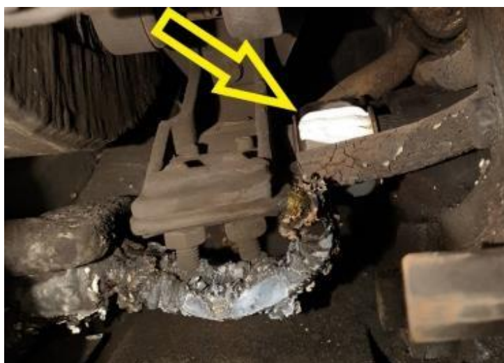
Imaginea 7 – izolator spart în interiorul MET4
