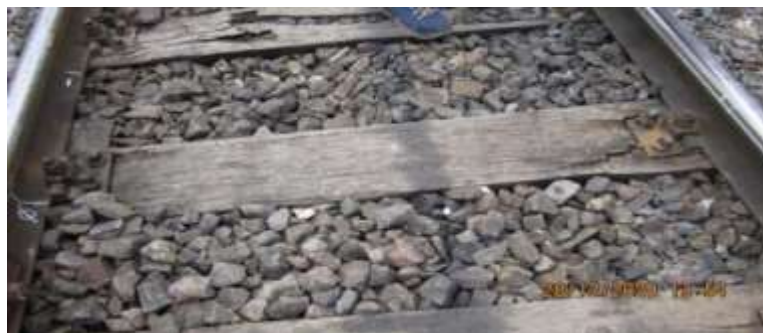
Foto nr.10 Starea traverselor T 0 , T -1
