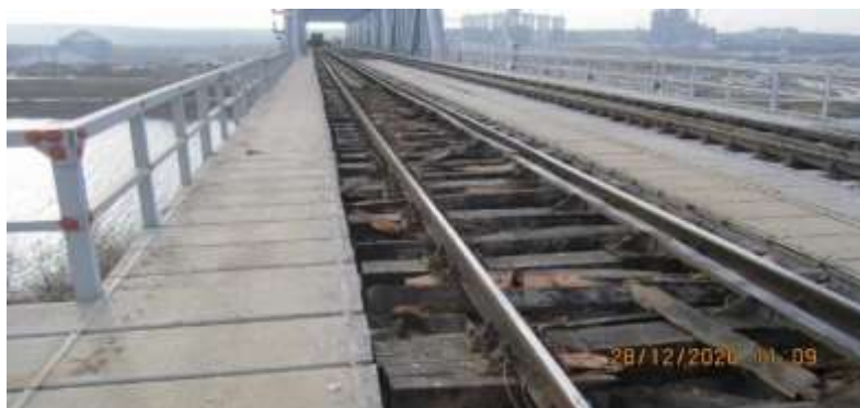
Foto nr.7 Contrașina de pe viaductul I capX ruptă
