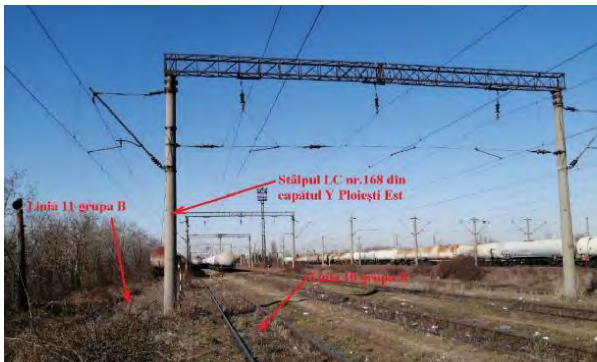
Foto nr. 9 - stâlpul LC nr.168 din capătul Y al stației Ploiești Est (efectuată la data de 23.03.2022)
