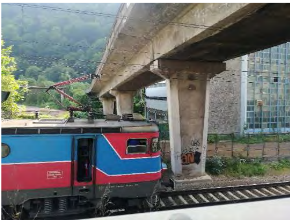
Foto nr. 8 - pasarelă dezafectată situată între stațiile Sinaia și Bușteni la km 131+800
