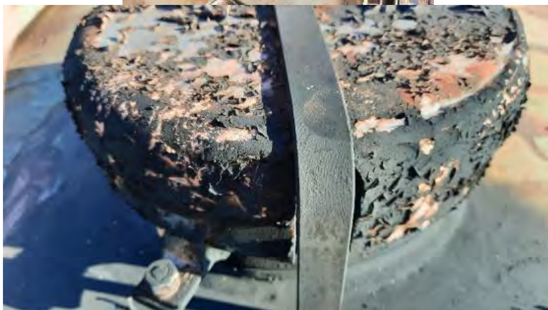
Foto nr. 4 - urme de afectare termică în zona supapei exterioare afereantă dispozitivului de punere la atmosferă (DMA)
