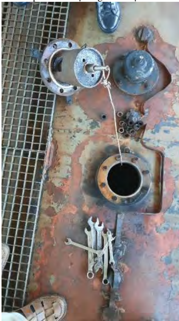
Foto nr.7 - supapa DMA demontată de recipientul vagonului
