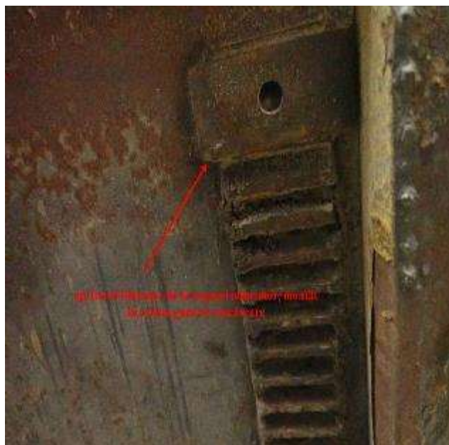
FOTO nr.8, opritor-limitator montat la capacul obturator de la a doua gură de golire
