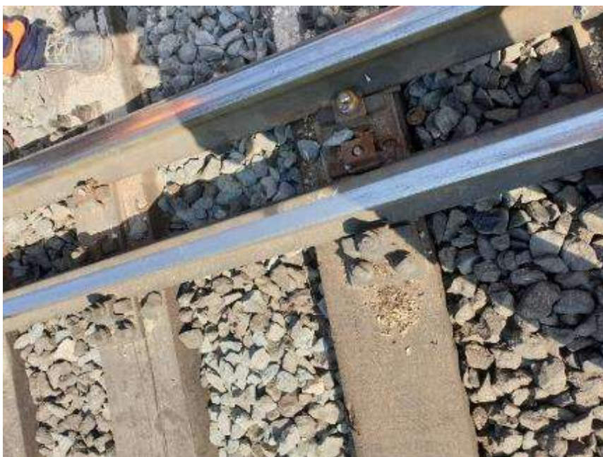
Foto nr.4 - buloane afectate de circulația în stare deraiată a vagonului
