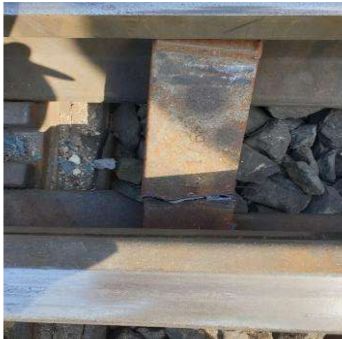
Foto nr.5 - proțap al macazului nr.17 rupt
