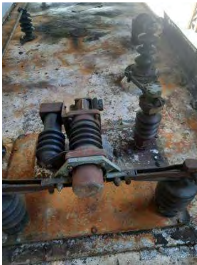
Foto nr.1 – disjunctorul locomotivei tip DBTF
