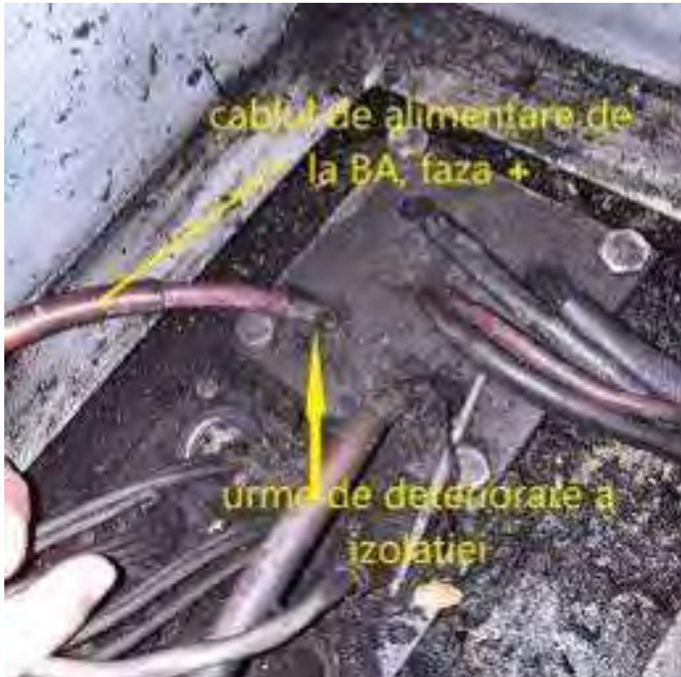
Foto nr.21 - cablul de alimentare cu curent continuu, de la BA la blocul S7 , în zona traversării de sub locomotivă.
