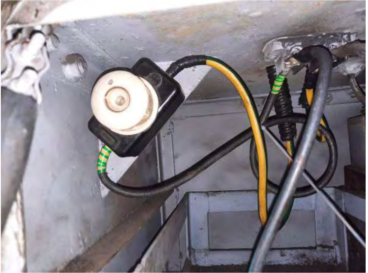
Foto nr.22 - siguranța fuzibilă montată în interiorul nișei de baterii.
