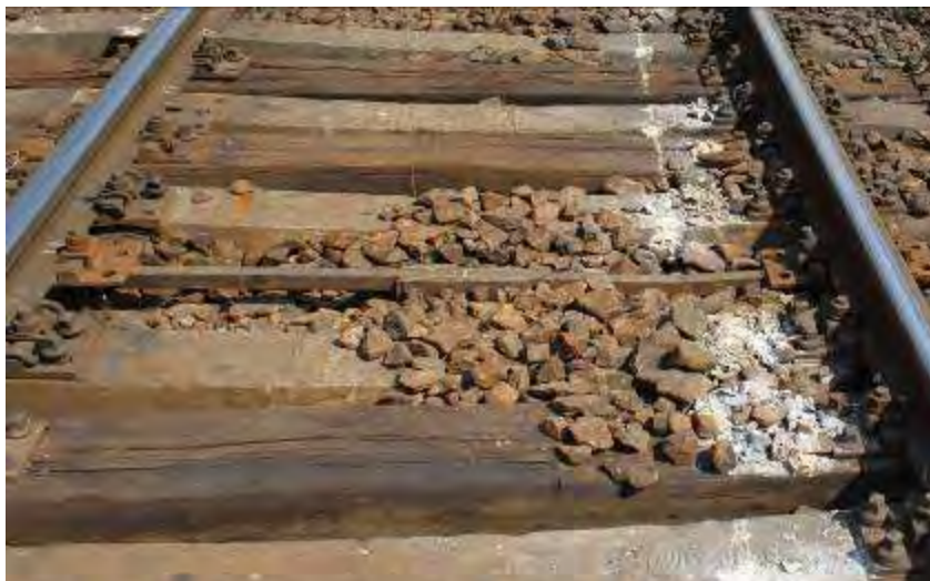
Foto nr.8 - introducerea traverselor de lemn între traversele de beton (plăci metalice lipsă la traversele de beton)
